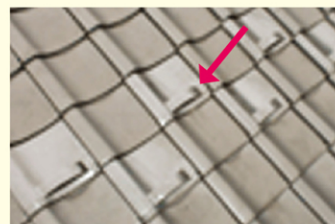
1列増設した雪止め瓦
