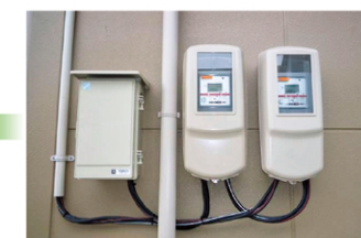
売電メーター設置 （これで電気を売り買いできます）
