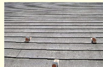
色あせの進んだコロニアル屋根（築12年）
